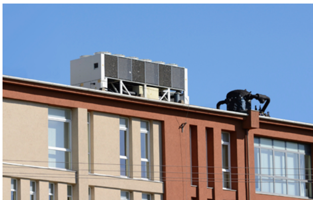
Tradycyjna instalacja na dachu.
